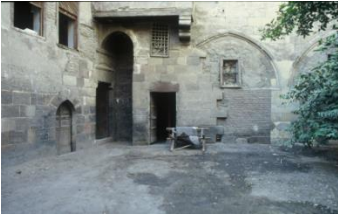
صوره 15 الحوائط المبنية داخل العقود - قبل الترميم
